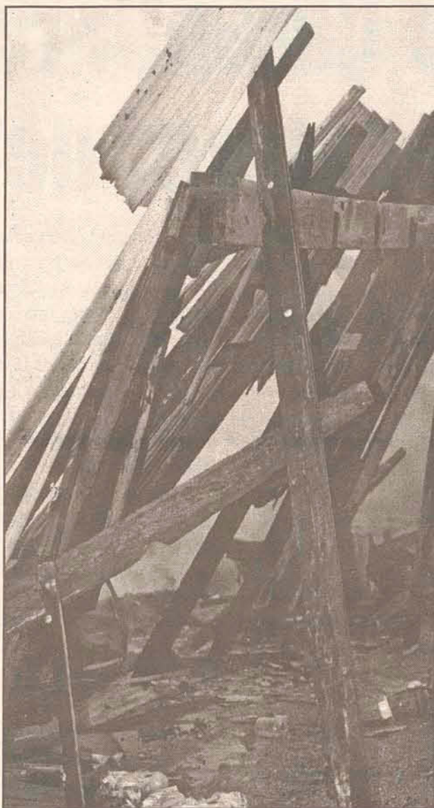
A casa foi totalmente destruída
