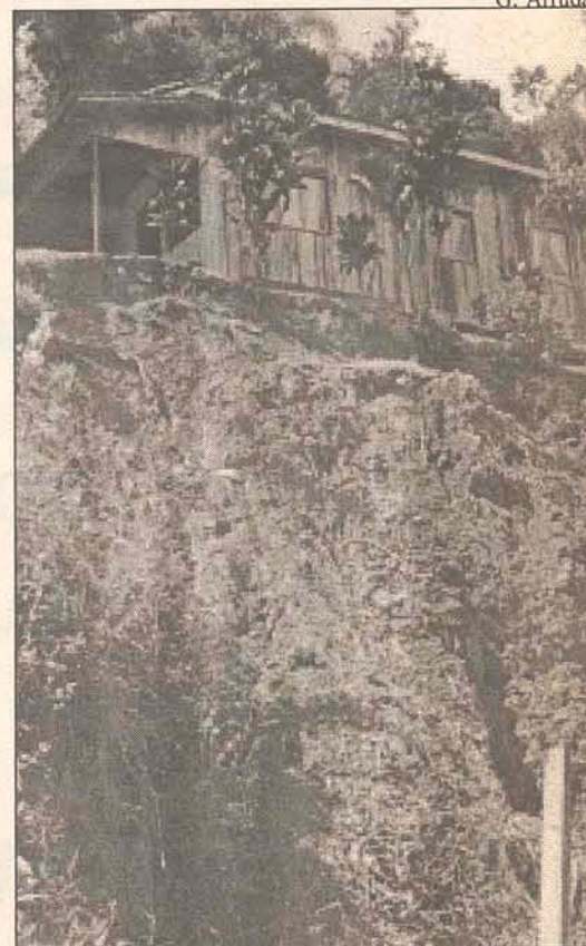
Casa ameaçada de desbarrancamento
