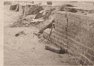
Imagem parcial da destruição no Farol. O muro de arrimo está assim
