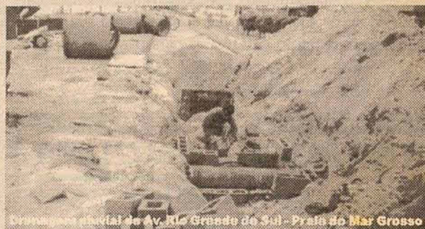
Drainagem pluvial de Av. Rio Grande do Sul - Praia do Mar Grosso
