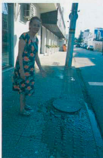
Dona Vilma indignada com o esgoto a céu aberto
