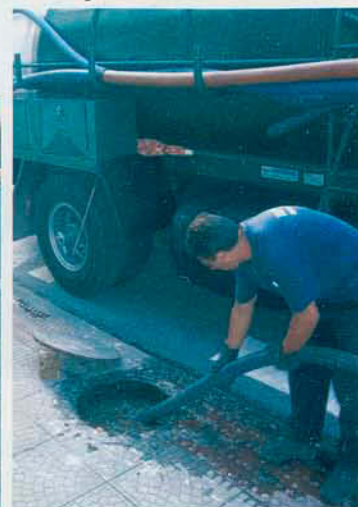
Funcionário terceirizado da Casan fazendo a sucção do esgoto
