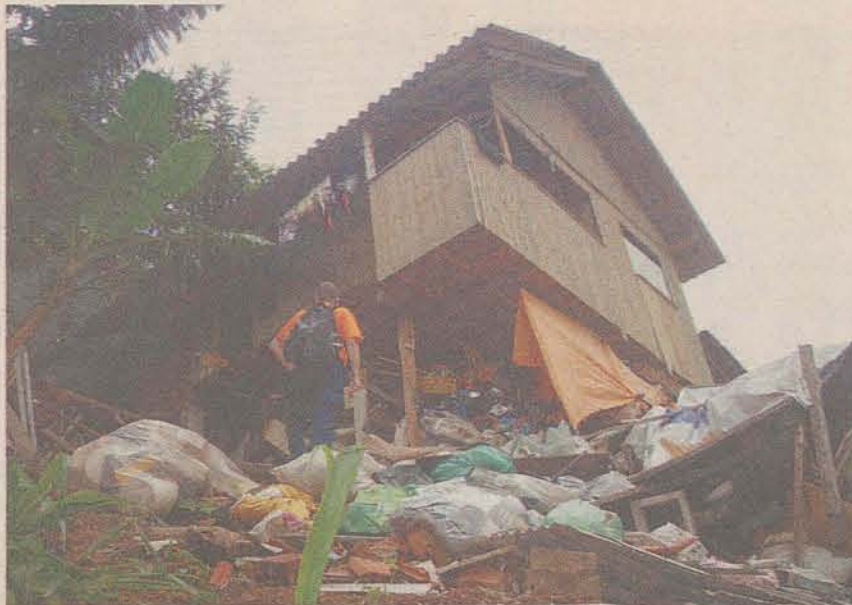
INTERDITADA: Defesa Civil deu prazo para demolir casa ameaçada de cair
