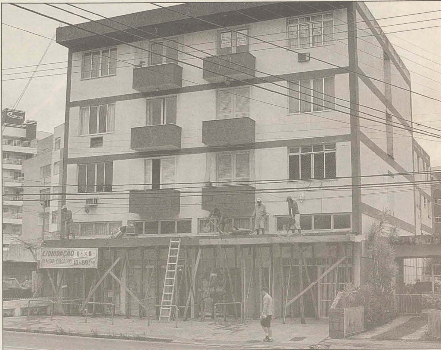
DISCUSSÃO: síndica manda derrubar marquise e provoca furor entre os moradores do prédio da Avenida Max de Souza
