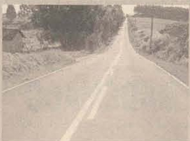
*FAG 050 Pavimentação de 8,9 km do acesso que liga Faxinal dos Guedes a Barra Grande
