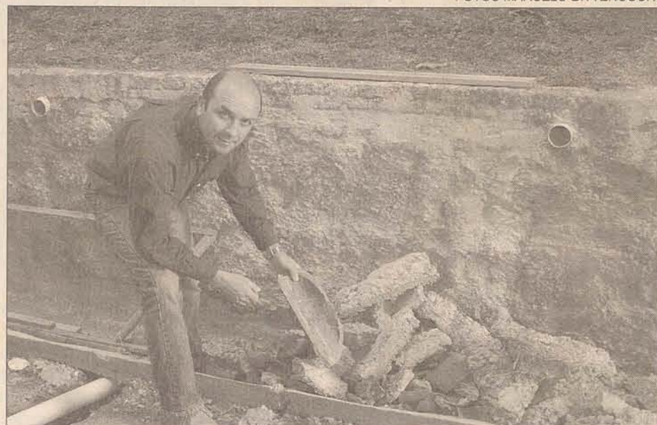
RATOS E BARATAS: engenheiro Marcos Antônio mostra tubulação antiga que provocou a proliferação de bichos e mau cheiro
