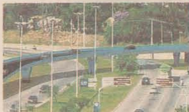
Elevado do Itacorubi: Obra em construção com prazo de término previsto para setembro de 2007.
