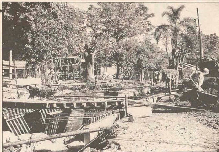
PERIGO: Obra de drenagem na rua Bento Goia causa polêmica
