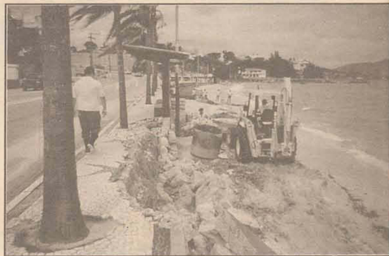
Além do calçamento das praias do bairro, maiores prejuízos foram os deslizamentos e destruição de casas no Morro da Caixa
