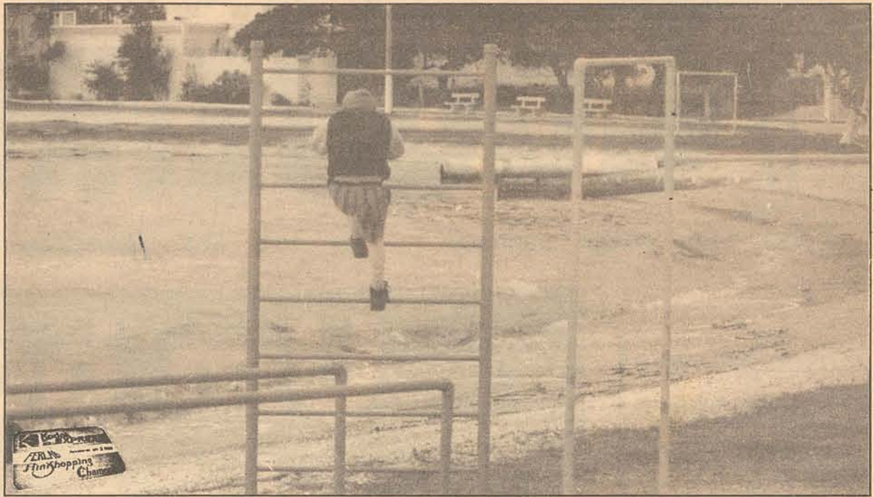
Instalação de equipamentos esportivos na beira da praia é um dos últimos investimentos
