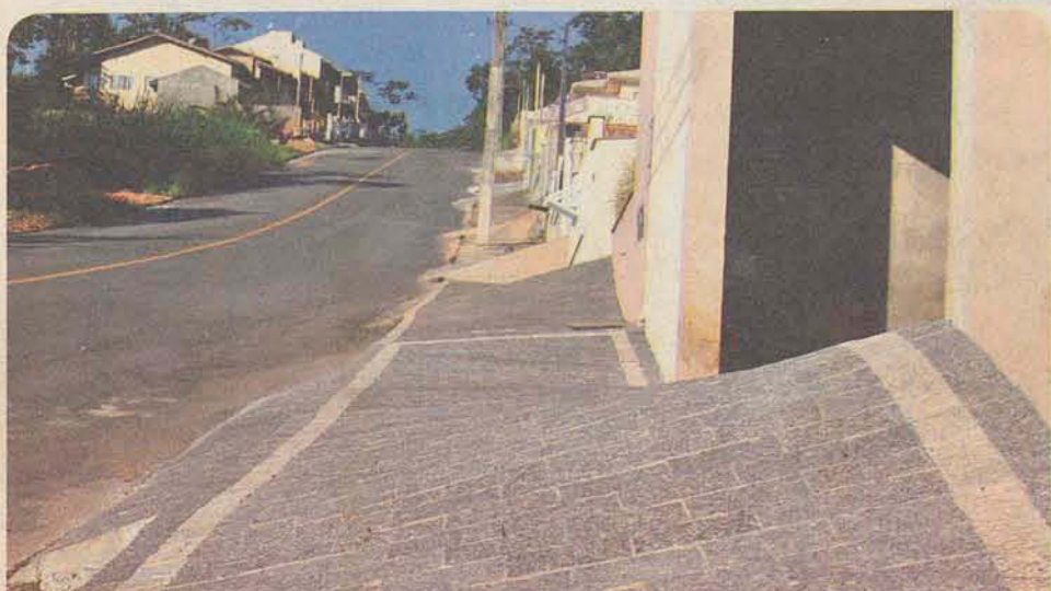
Um estudo desenvolvido por técnicos da Prefeitura mostra que quase 100% das calçadas do município estão em péssimo estado ou construídas irregularmente. Lei específica vai disciplinar a padronização
