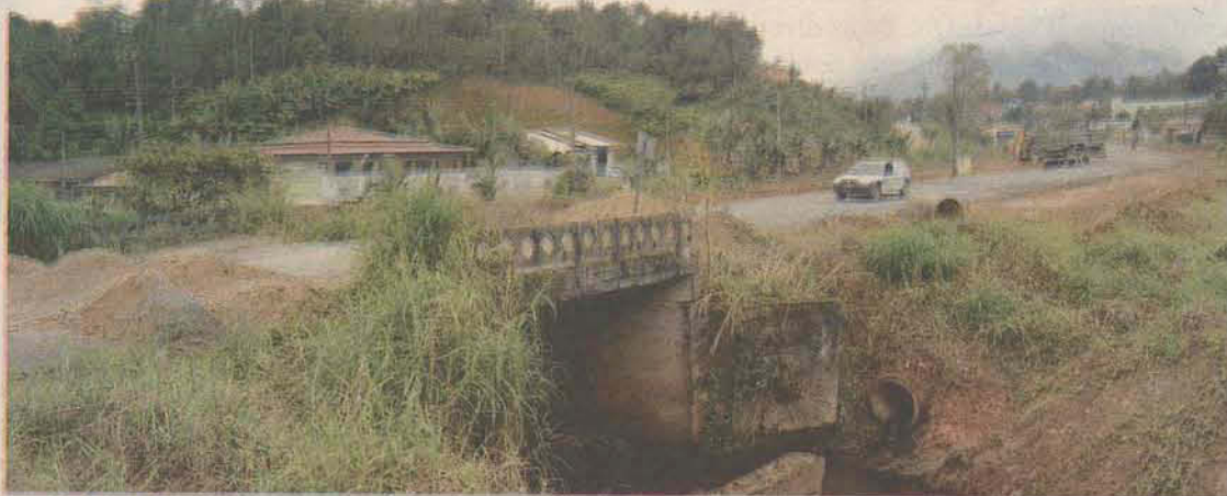
MELHORIAS Pontilhão, que havia cedido, está parcialmente interditado e será recuperado
