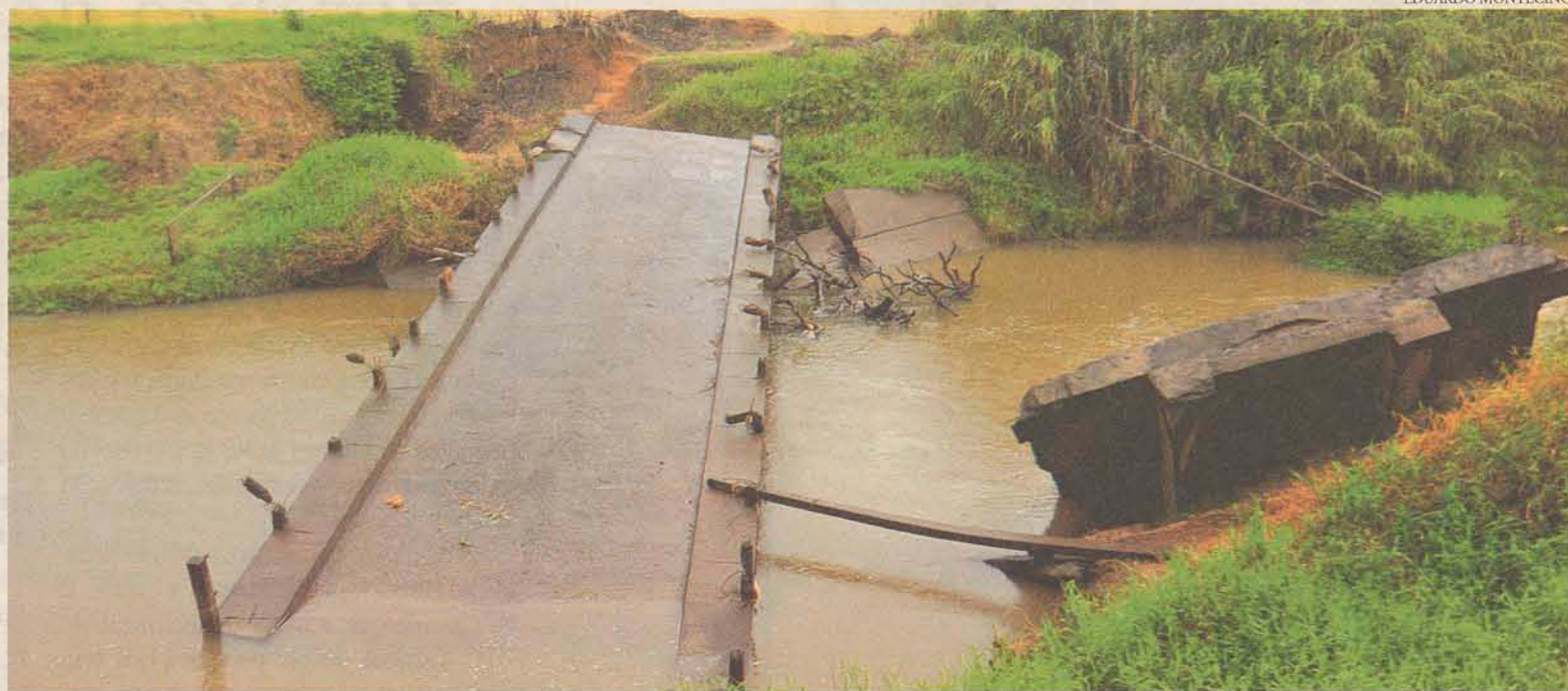
DANOS A estrutura foi danificada pela cheia de 2011 e, desde aquele período, ficou destruída. Recuperação vai custar R$ 587 mil
