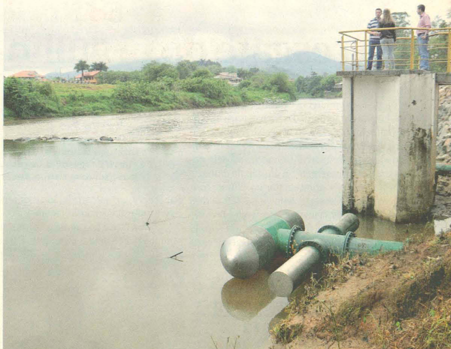
SAMAE Novo sistema de filtragem do setor de coleta da água do rio Itapocu
