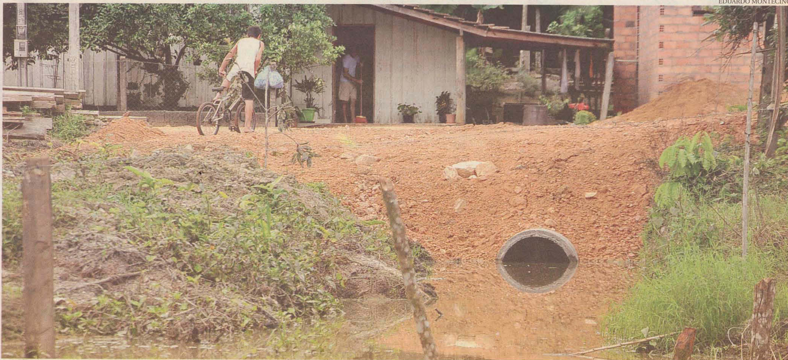
INSALUBRE Dejetos das casas caem numa lagoa. Local apresenta riscos à saúde dos moradores, atrai insetos e causa mau cheiro
