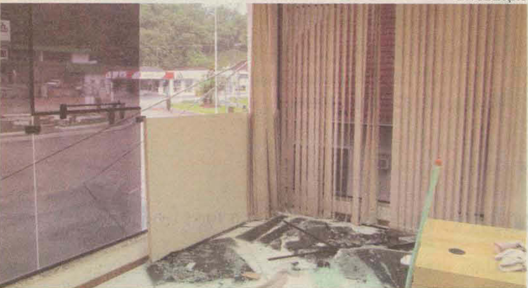
SALA DO PREFEITO Vidraça do gabinete quebrou
