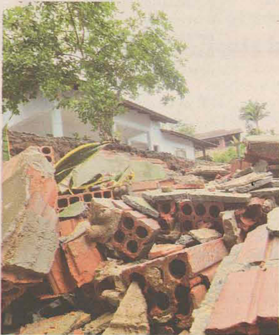
QUEDA Muro não resistiu ao volume de água
