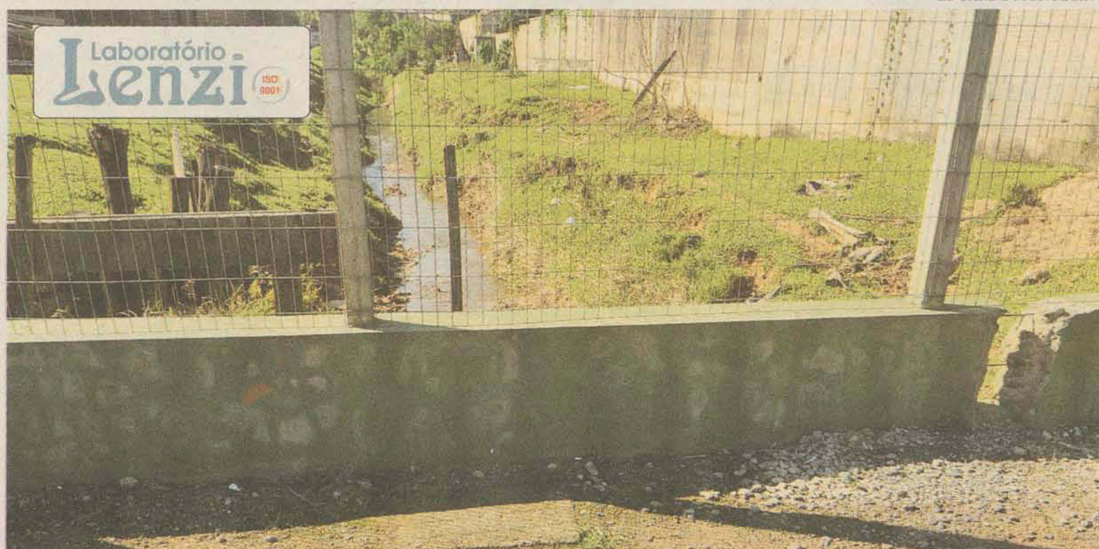
IMPROVISO Moradores da rua Vitória Spézia abriram fenda em muro para passagem da água
