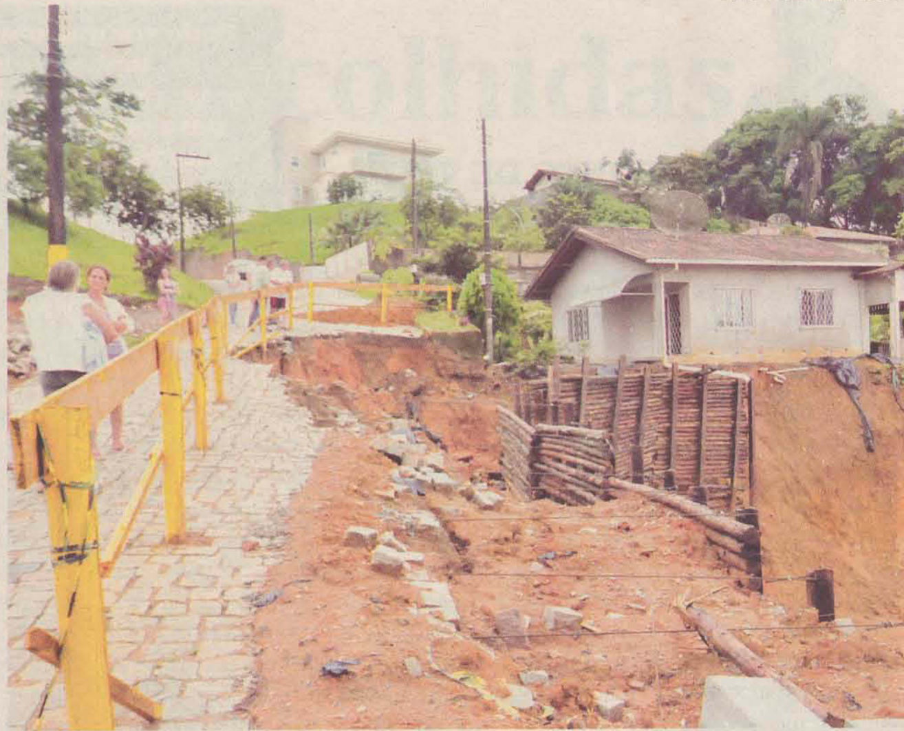
DESLIZAMENTO Chuva provocou queda de barranco no Jaraguá Esquerdo
