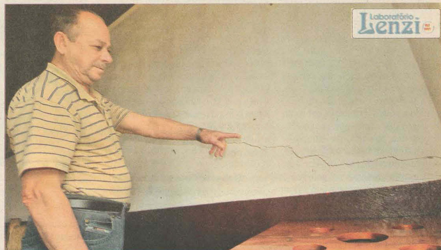
RECLAMAÇÃO Trânsito pesado de caminhões na rua Henrique Nagel causa rachadura em residências e comércio, mostra comerciante José Pereira
