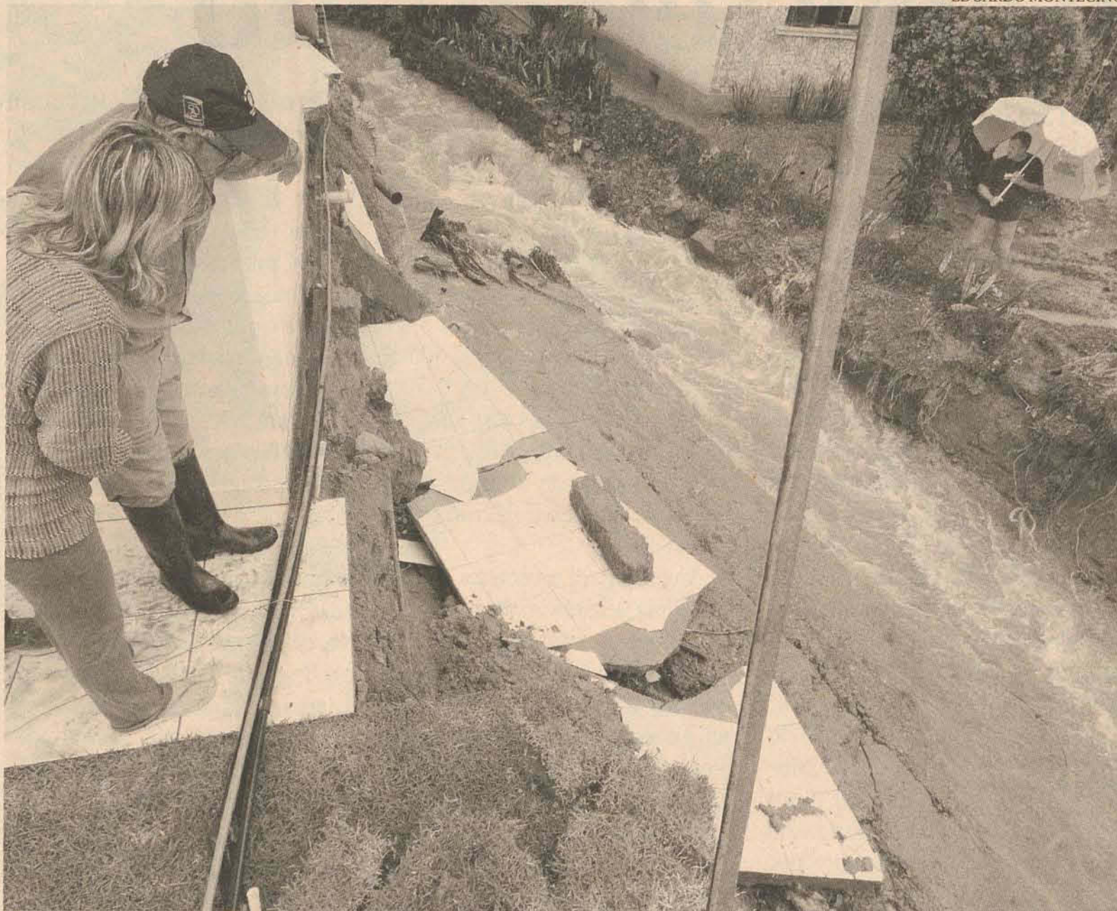
Às 4h da madrugada de ontem, o muro da residência da dona de casa Rita de Cássia Wiltuschnig cedeu ao lado do terreno, na rua Henrique Marquadt, bairro Czerniewicz. Ao longo da manhã, pedaços da calçada caíram. A moradora se queixou da falta de obras de contenção na beira do rio. A Defesa Civil fez o primeiro atendimento e encaminhou o caso à Secretaria de Obras, que removeu o excesso de material do rio. A previsão é que as obras de contenção e recuperação iniciem quando a chuva parar.
