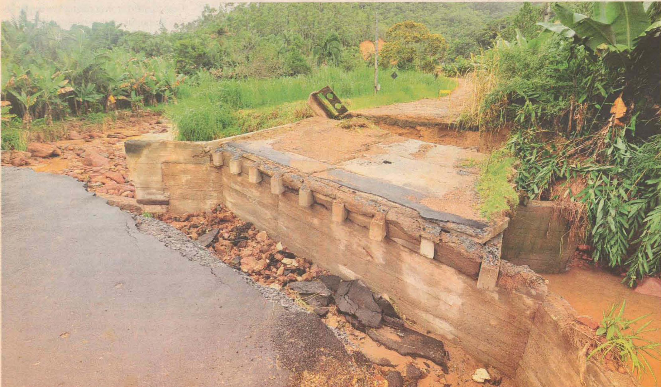
Estrada geral de Ribeirão Grande do Norte, conhecida como Rota dos Hotéis, está entre os pontos mais afetados. Ponte na localidade cedeu em virtude da força das águas.
