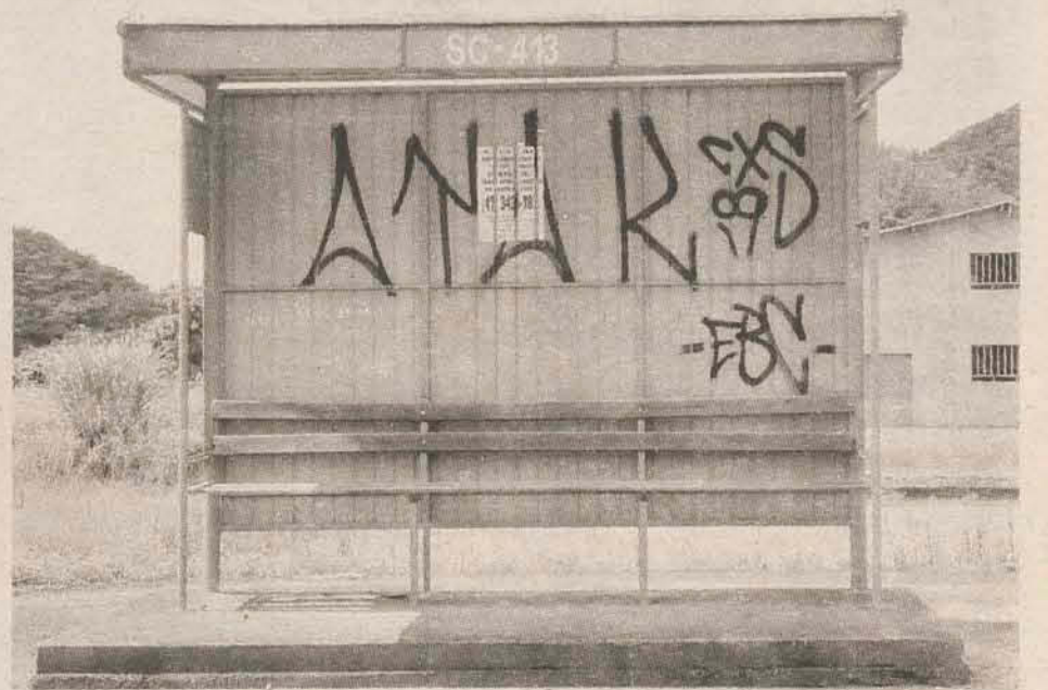
Vandalismo já foi constatado pelo OCP em janeiro de 2010
