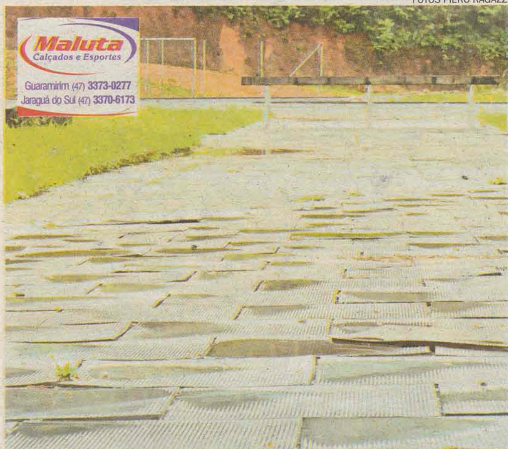
Pista foi inaugurada no fim de 2008 e em janeiro piso j  estava descolado
