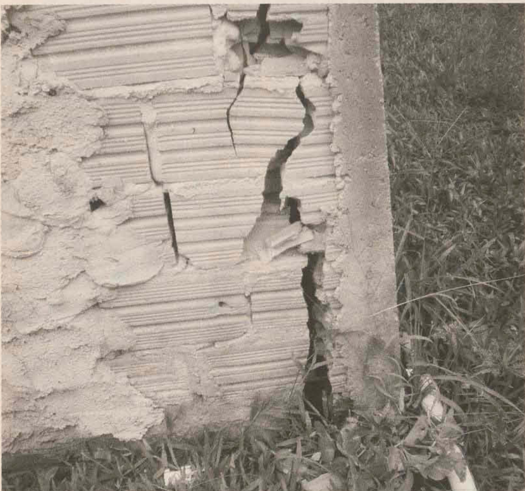
Na Tifa Schubert, cinco residências apresentaram rachaduras
