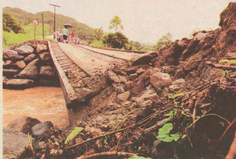
Ponte já havia sido danificada com as chuvas do mês passado
