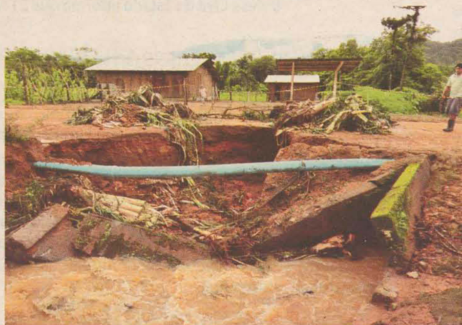
Enxurrada destrói galeria e parte de estrada no Bracinho
