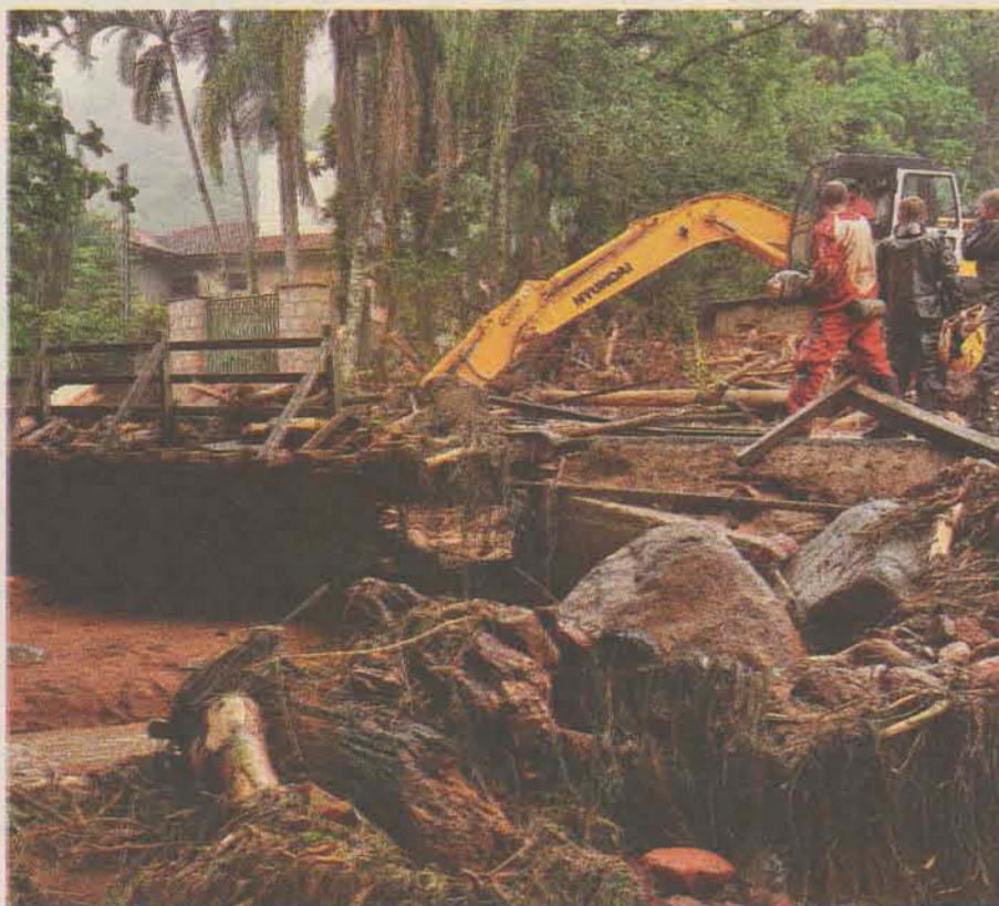
Ponte foi danificada, no bairro Santa Luzia
