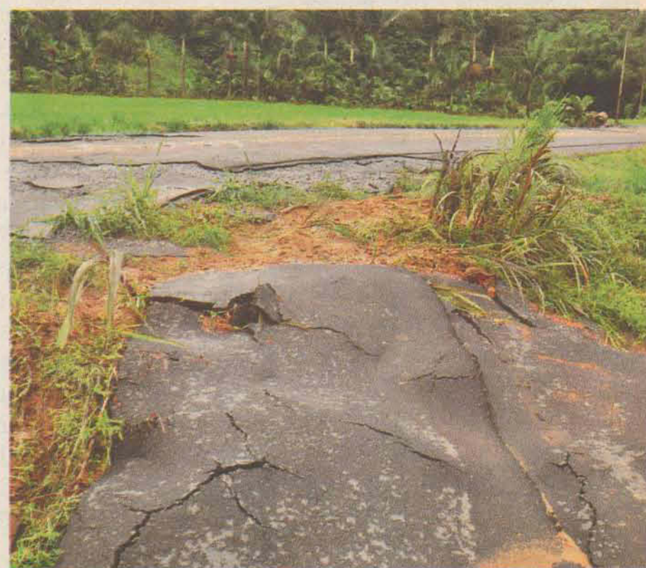
Na conhecida Rota dos Hotéis, asfalto recém colocado cedeu
