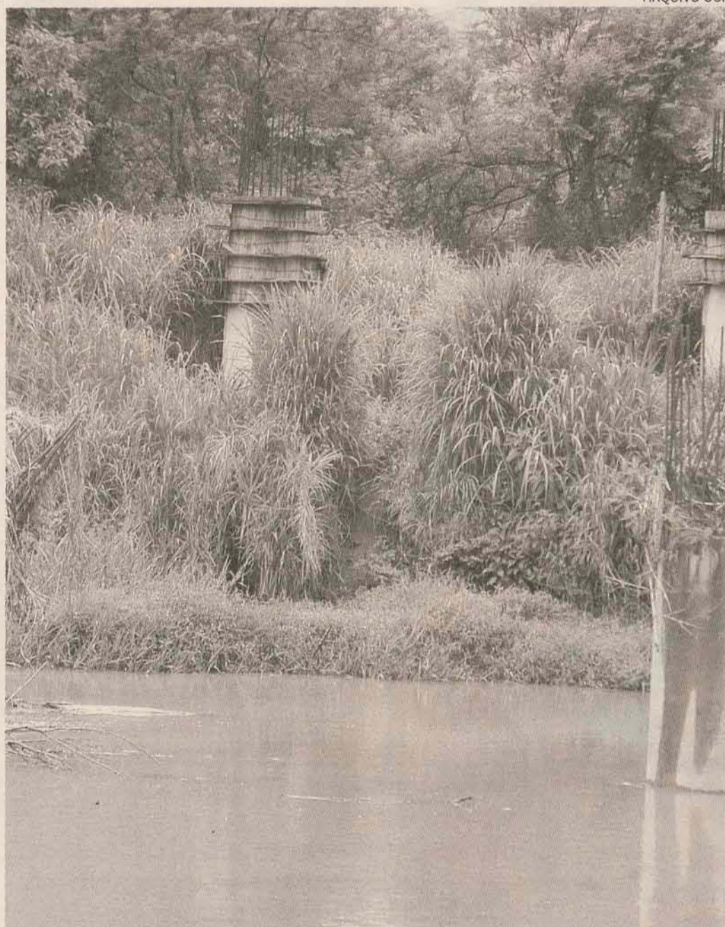
Segundo a Prefeitura, pilares já construídos não podem ser utilizados
