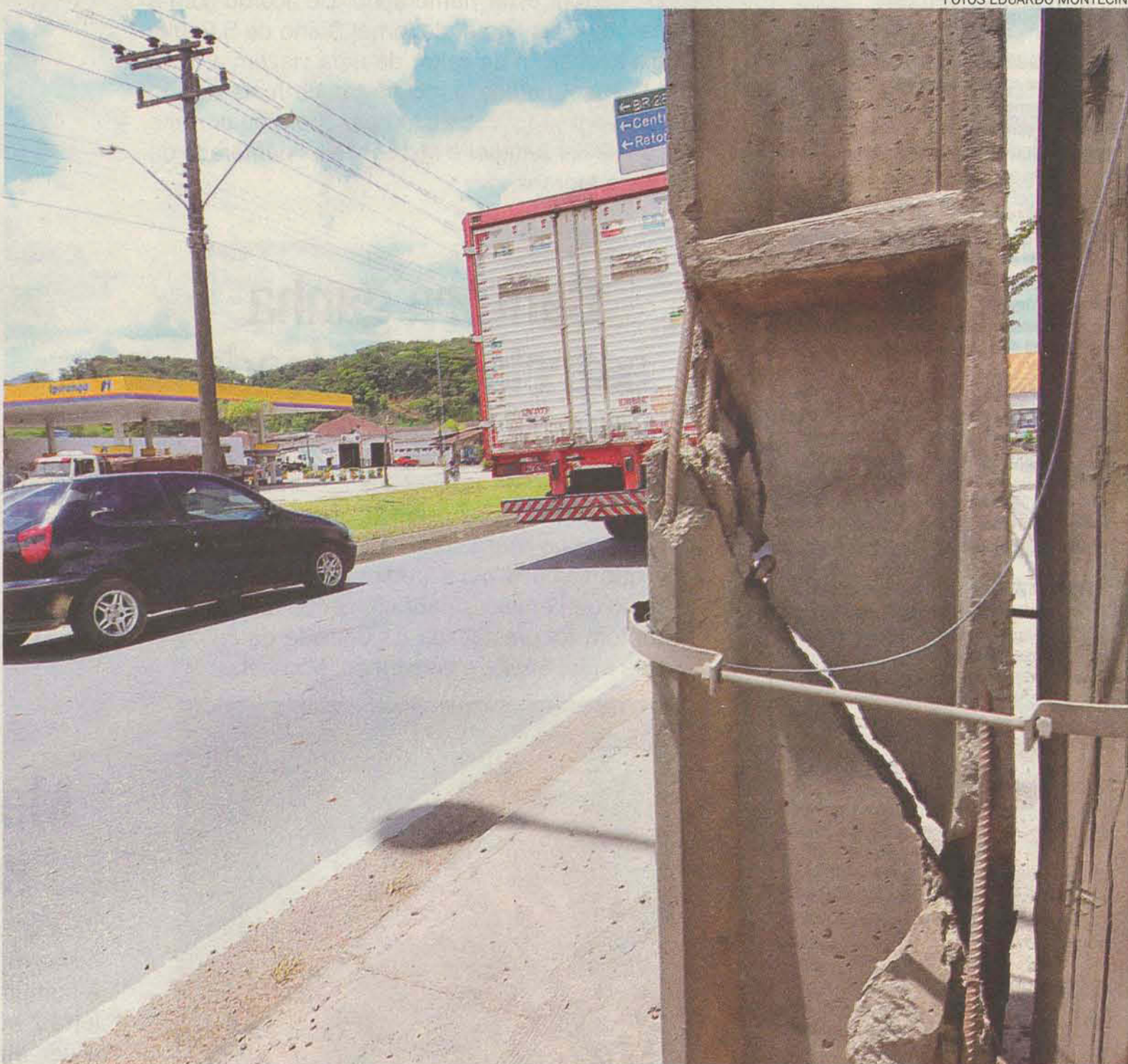
Poste na Avenida Waldemar Grubba é um dos que foram remendados por causa da baixa no estoque da Celsc
