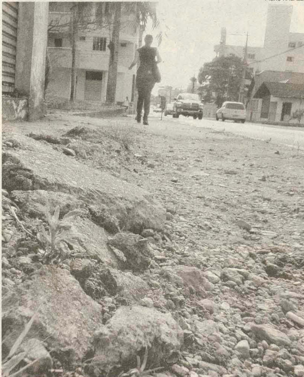
Das centenas de calçadas construídas por ano, apenas 10 ou 15 seriam feitas de acordo com a lei, segundo fiscal
