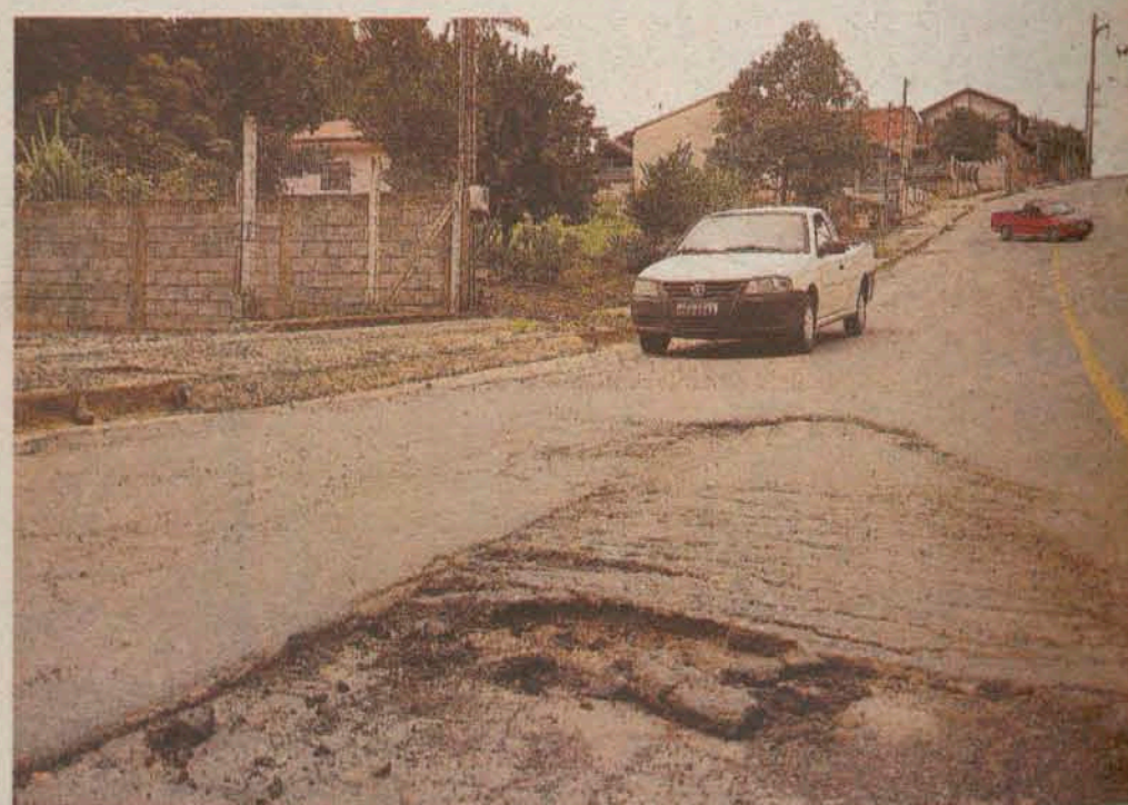
Buracos tomam conta da rua José Narlock, no bairro São Luís
