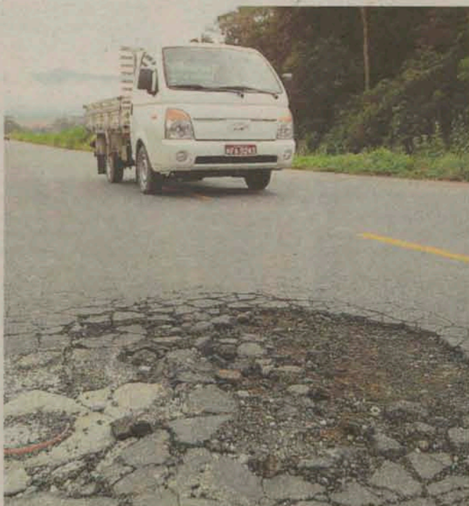
Estrada geral que dá acesso ao município de Corupá, na localidade de Nereu Ramos, possui crateras em sua extensão
