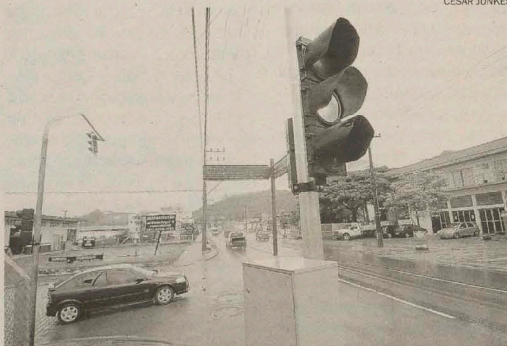
Equipamento foi recuado e instalado no acesso à rua Domingos Sanson
