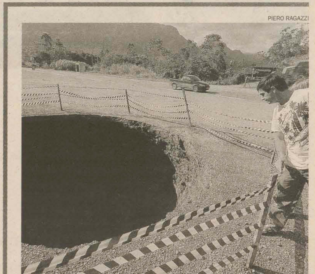
Infiltração teria causado problema. Obras começam segunda-feira
