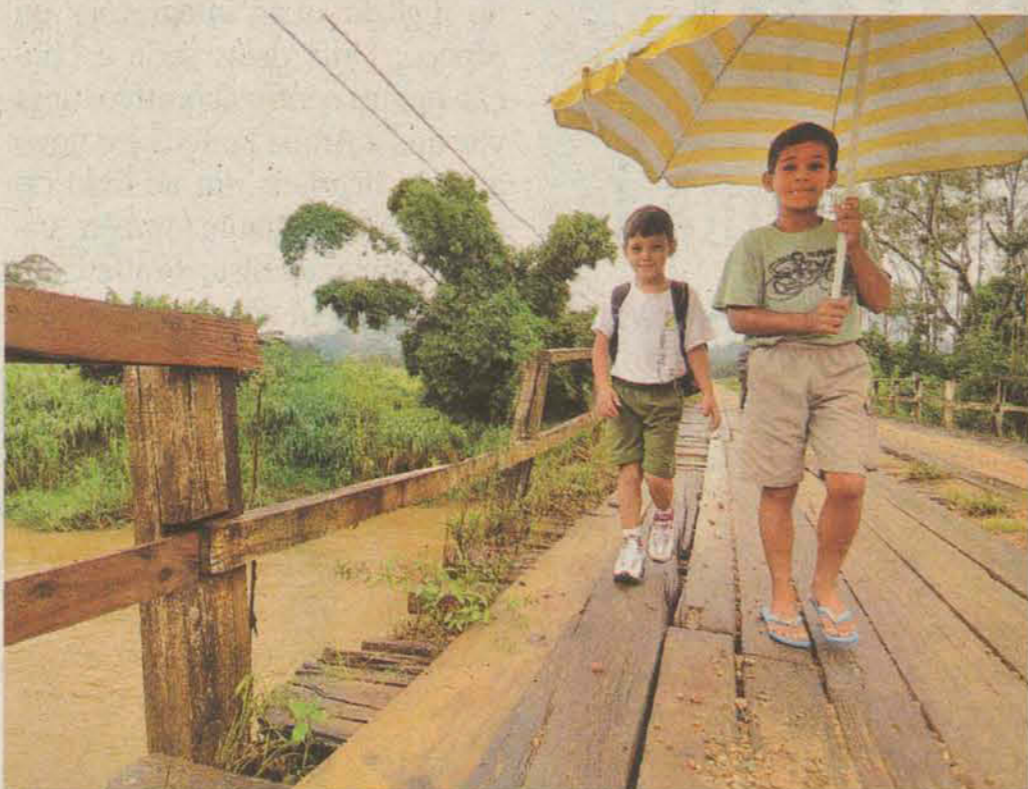
Ponte da Trindade teve estrutura danificada. Trânsito já foi liberado
