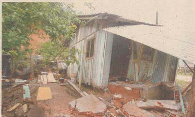
Município tem cerca de cem imóveis interditados pela Defesa Civil
