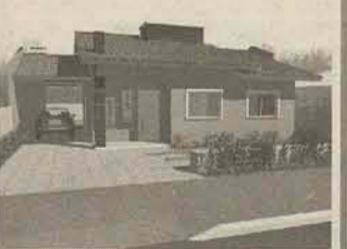
TRÊS RIOS DO SUL - LOTEAMENTO BEIRA RIO - Casa em construção com suite mais dois dormitórios, bwc social, sala, cozinha, lavanderia, churrasqueira, garagem. R$ 175.000,00.
