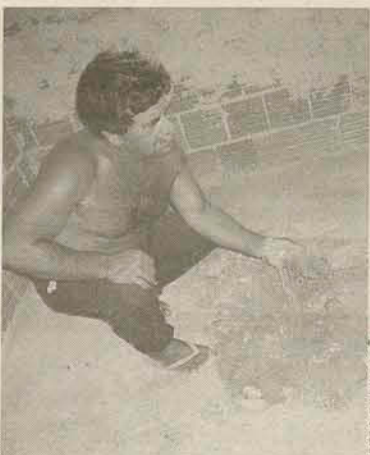
Janelas têm dimensões diferentes das projetadas e o piso está esfarelando
