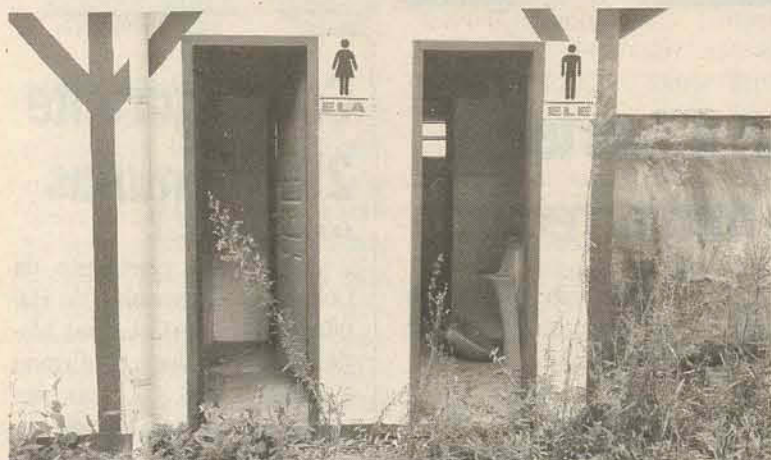
Banheiros foram quebrados e utensílios levados por vândalos
