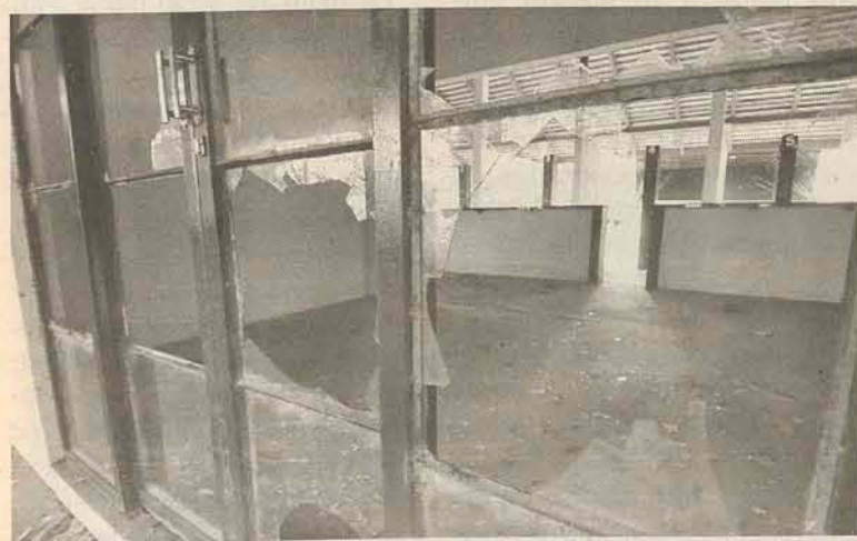
Vidraças estão quebradas, assim como portas que dividem o Parque
