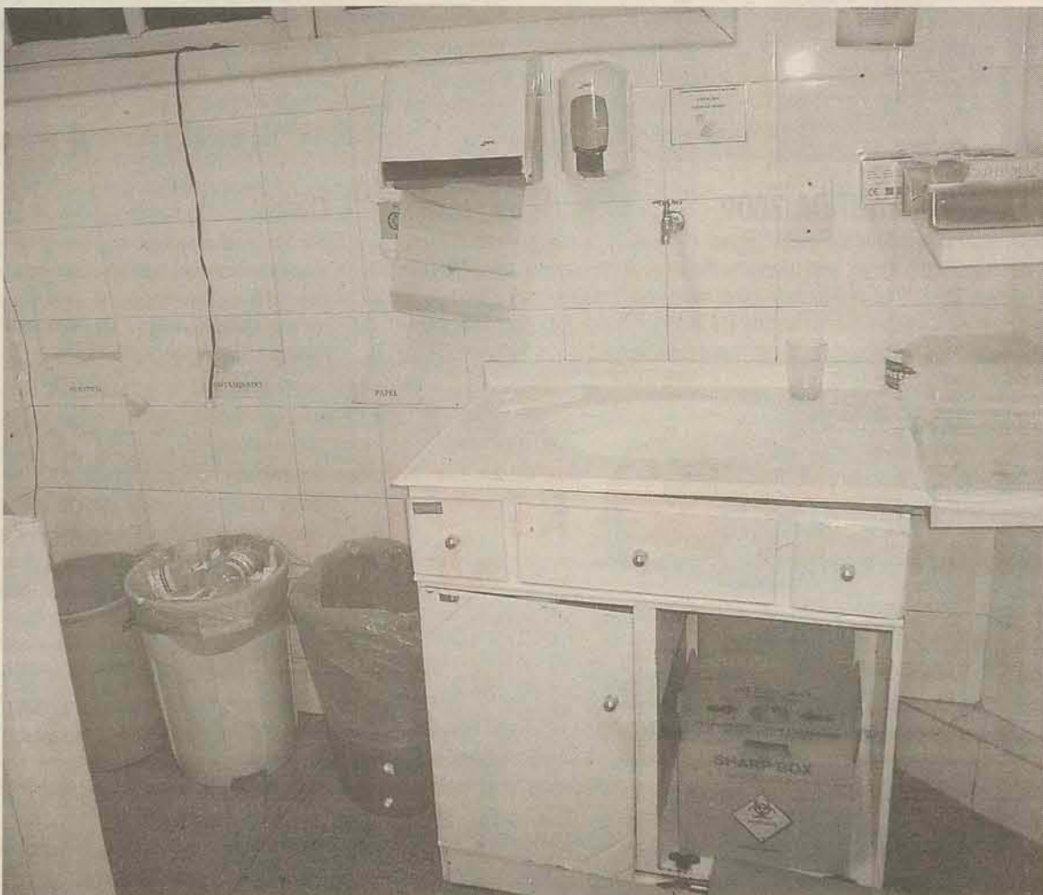
No PA 24h, armário em condições precárias serve para guardar medicamentos, denuncia nova administração
