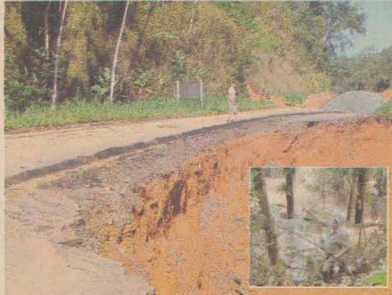
Motoristas arriscam passagem, mas acabam acessando o desvio. Prefeito mostra lago formado pela represa
