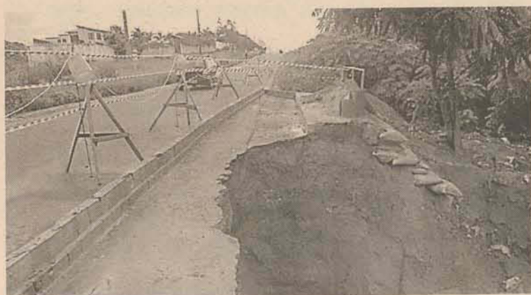
Erosão danifica rodovia MA-203, que liga a capital São Luís a Raposa
