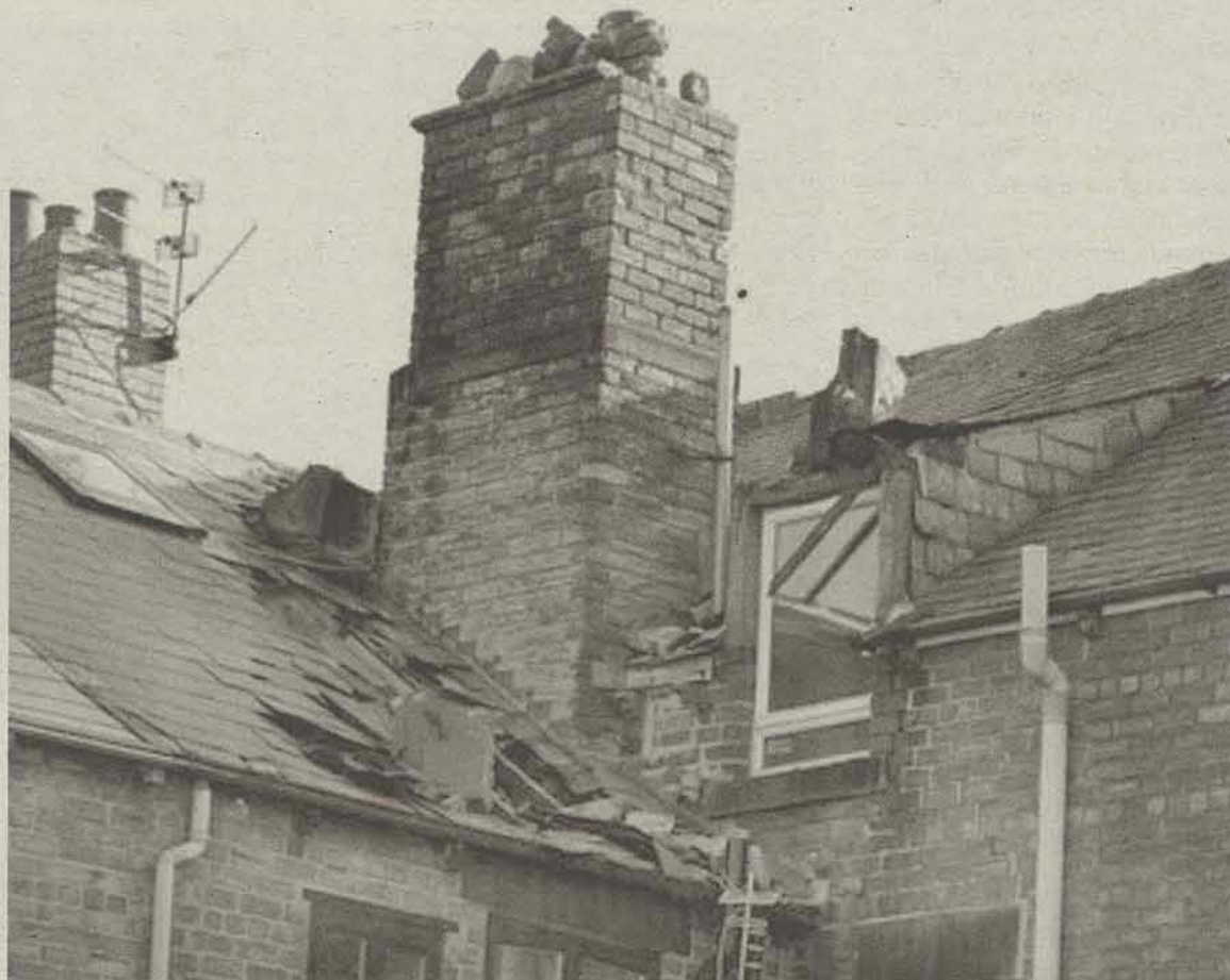
O pior tremor na Inglaterra em quase 25 anos destruiu principalmente telhados e provocou rachaduras em casas
