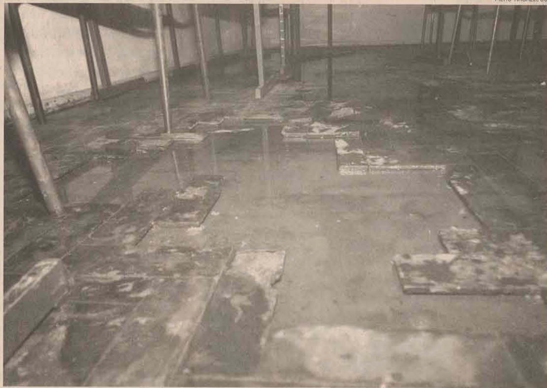
Sala tem o piso comprometido por poças de água que impedem os alunos de ter aula
