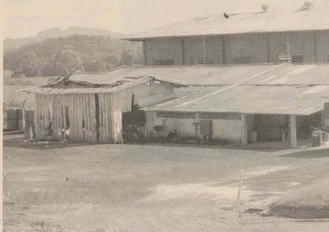
Prédio de madeira ficou danificado por causa das chamas e vai ter que ser demolido, segundo bombeiro
