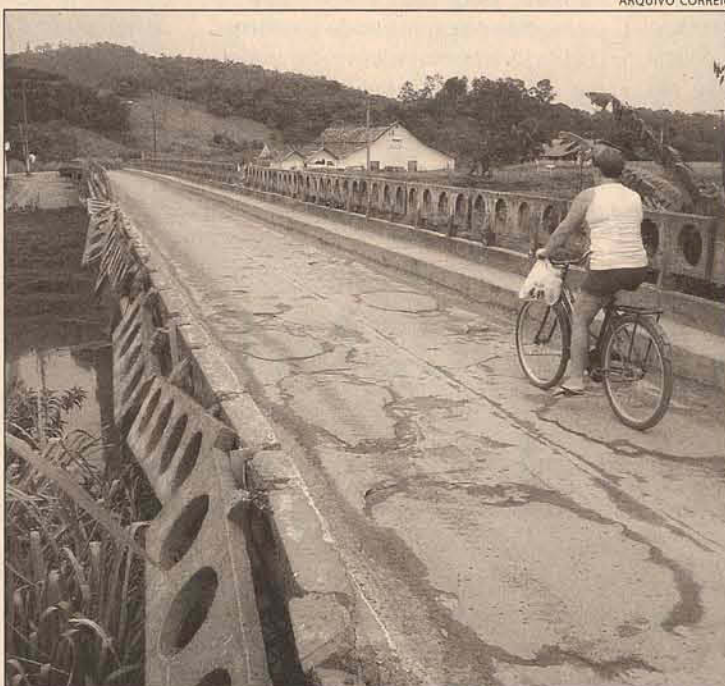
Situação da ponte em março deste ano, sem lateral
