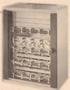
Racks para distribuição de redes
