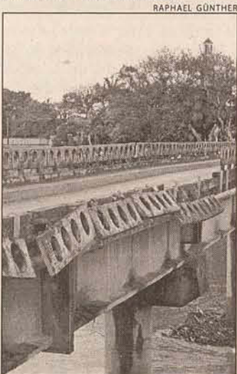
Ponte com lateral destruída
