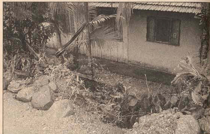
O muro desta casa foi derrubado pela patrula da Prefeitura
