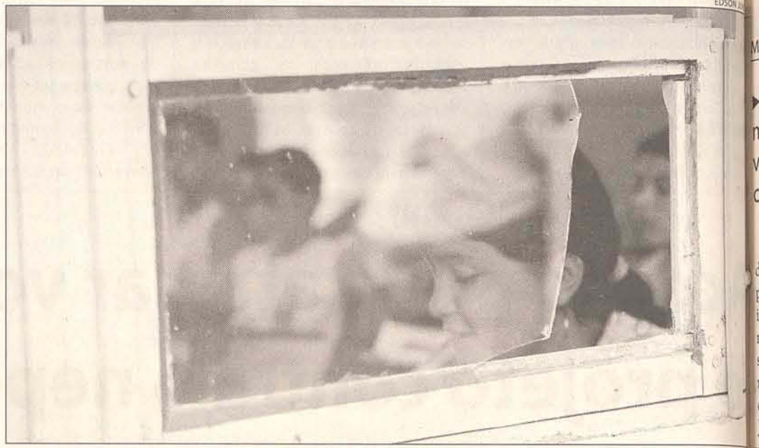
Vidros quebrados são um perigo constante para as crianças e estão em quase todas as salas de aula.
