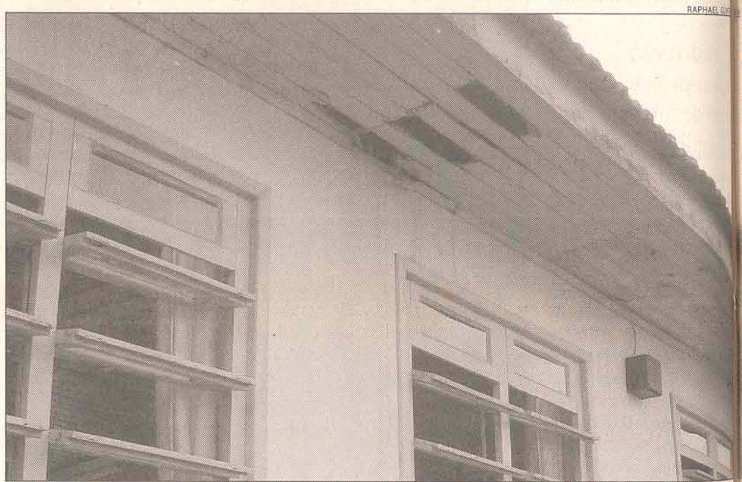
Outro perigo: os forros estão podres e os pedaços começam a cair. Também há muitos vazamentos
