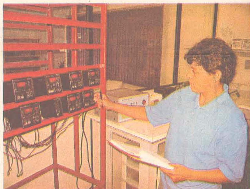
Janete da Silva, técnica da Tecsystem, analisando os controladores na fase final de testes
